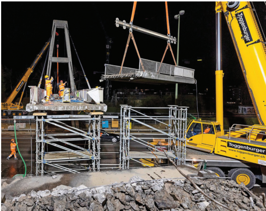
Die Überführung Oberwies bei Wallisellen wird abgebrochen und stückweise abtransportiert. Foto: Christian Merz
